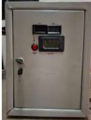
Gambar 3. Panel PLTS Tampak Depan
